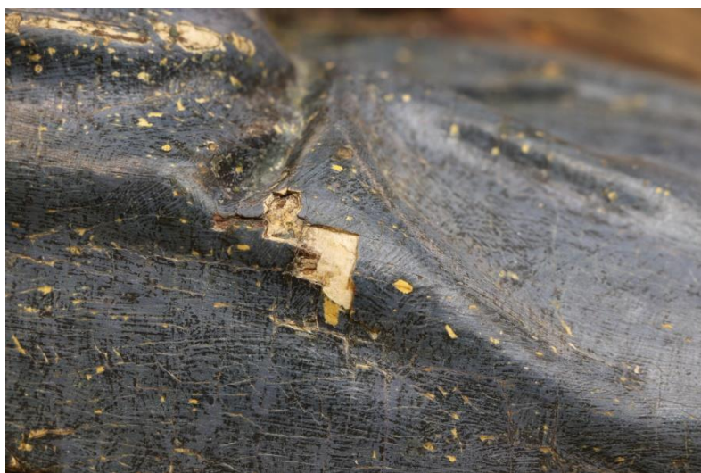
Obr.44 Modrý plášť P. Marie v defektu dobře viditelné dvě vrstvy klichokřídového podkladu
