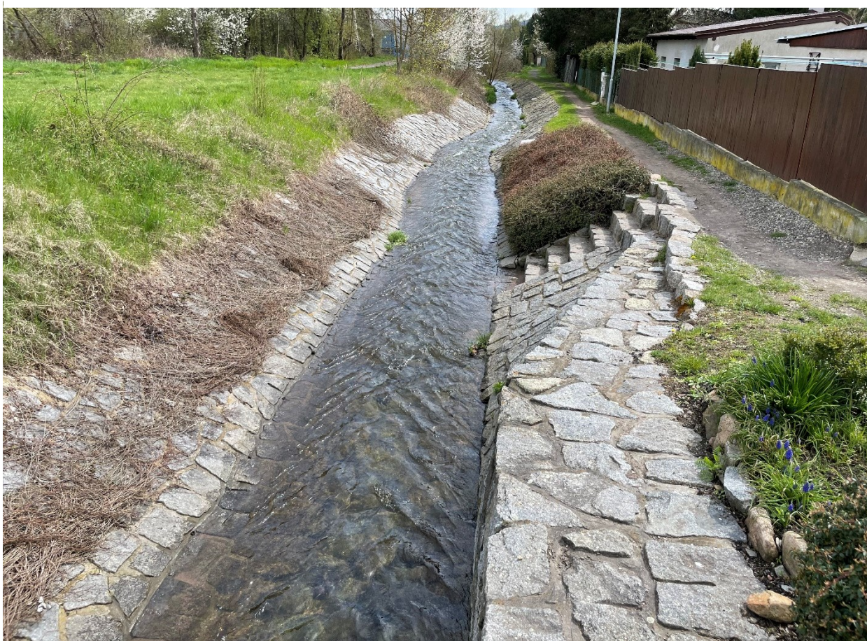
Obrázek 21 – Koryto v blízkosti ČOV je v dobrém technickém stavu.
