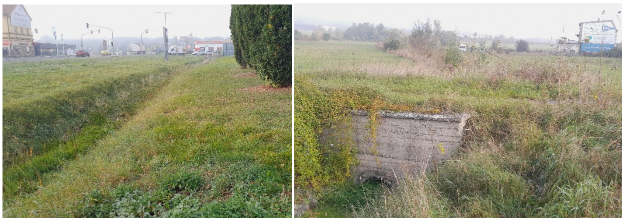
Obrázek 24, 25 – (vlevo) HOP v blízkosti silnice I/13, kterými se voda zpětně vzdouvá podél silnice. (vpravo) Terénní deprese na pozemcích ve vlastnictví JELÍNEK HOLDING a.s., která je zatápěna zpětným vzdutím.
