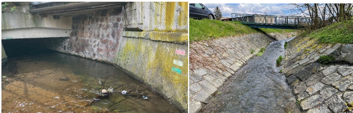
Obrázek 19, 20 – (vlevo) Zakrytý profil a označení SPA při vtoku. (vpravo) Lichoběžníkové opevněné koryto.
