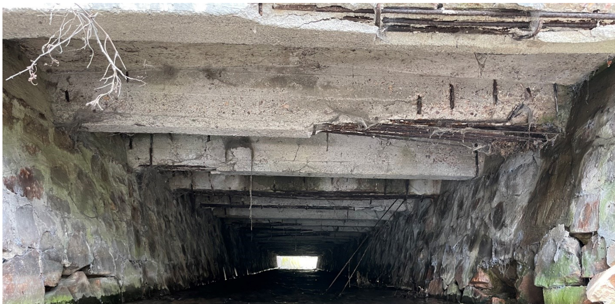
Obrázek 63– Zakrytý profil a degradované průvlaky.
