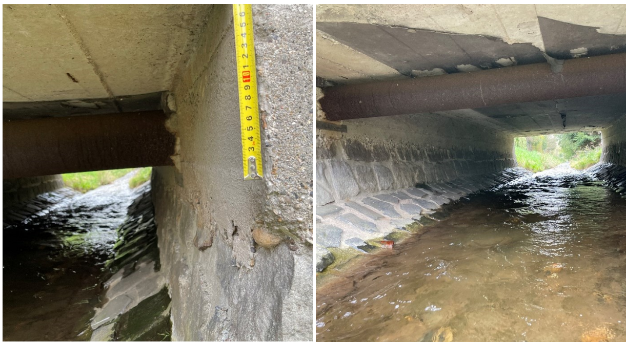
Obrázek 61, 62 – (vlevo) Nízké opěrné zdi by bylo vhodné při rekonstrukcích navýšit. (vpravo) Trubní chránička nevhodně situovaná v průtočném profilu.
