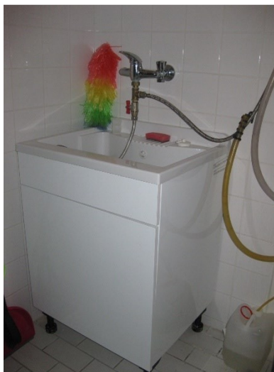
Výlevky do čistících místností
