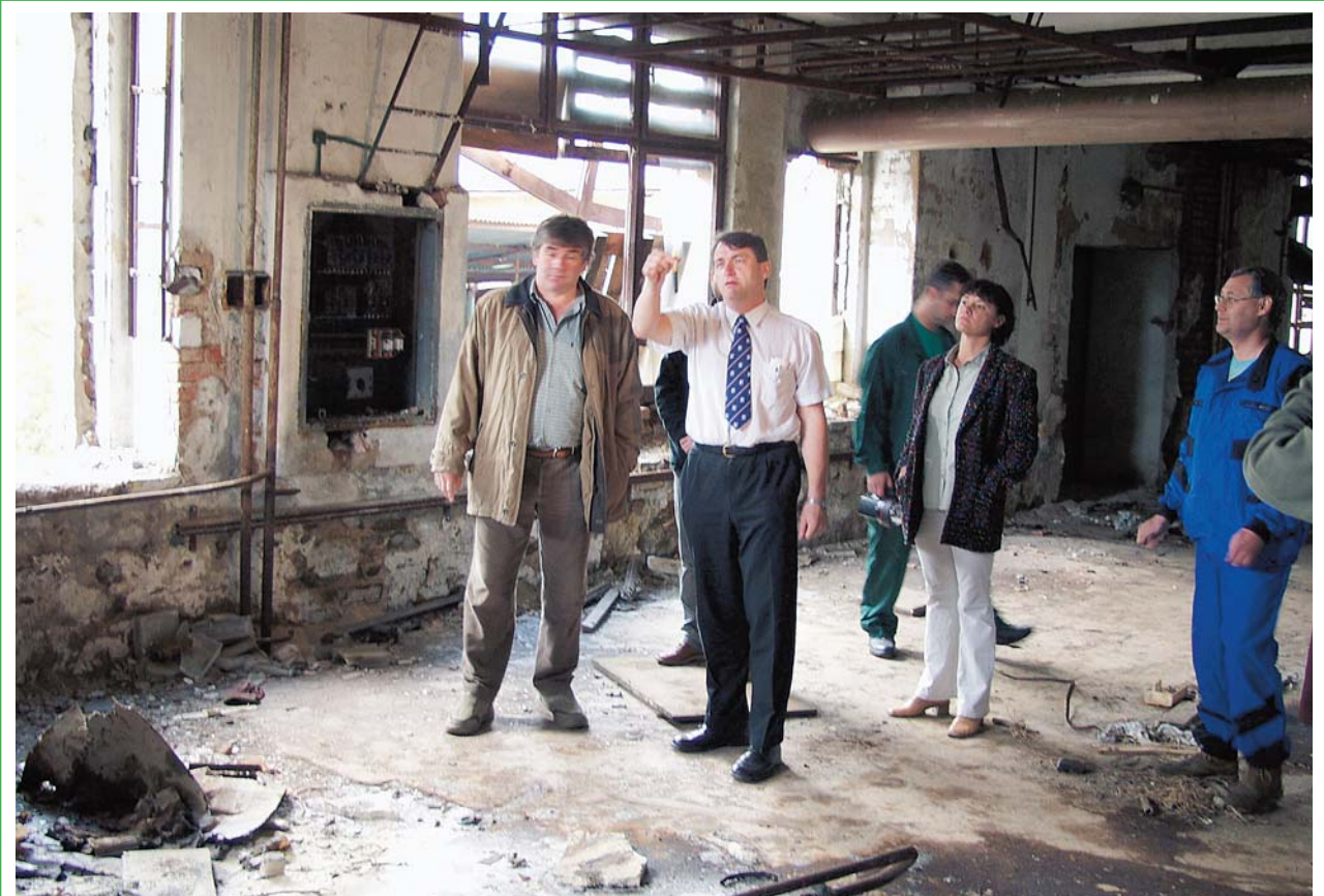
Okamžitý zásah v Loučné pod Klínovcem stál Ústecký kraj 400 tisíc korun – musel je zaplatit za podnikatele v konkurzu, který dlouhá léta skladoval chemikálie v rozporu s předpisy a situaci neřešil. Práce a opatření nutná k odvrácení havarijního stavu týkající se zejména akutního ohrožení kvality vod nakonec zaplatil kraj a zrealizovala ústecká firma P-EKO. V úterý 1. června přijel na zahájení likvidačních prací osobně dohlédnout hejtman Jiří Šulc.
