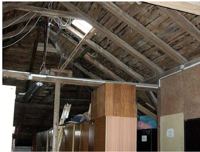
V Lobendavě, v tamním ÚSP, bude třeba vyřešit i půdní prostory, které jsou nevyužité a zatím tudy utíká spousta tepla z budovy. Skříňky slouží zdejšímu personálu!
