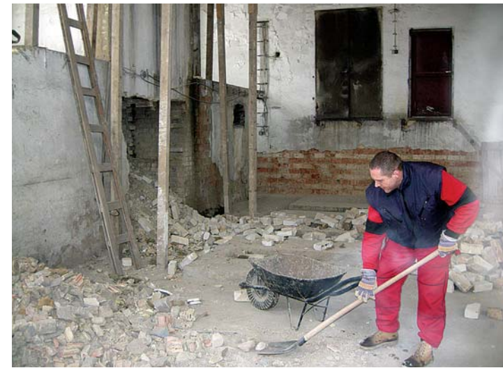
Součástí rekonstrukce a dostavby Domova důchodců ve Šluknově bude i nová společenská místnost v objektu bývalé kotleny. Bude mít dostatek místa, ochoz a na místě bývalého odtahu od kotle bude postaven opravdový krb.
