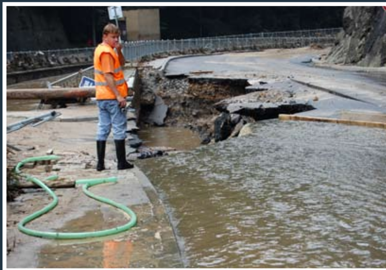
VELKÉ ŠKODY NAPÁCHALA VODA V HŘENSKU při srpnových povodních. Další ze zatěžkávacích zkoušek integrovaného záchranného systému.
