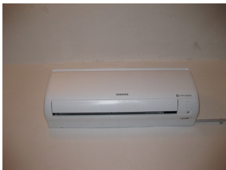
klimatizační jednotka v bramborárně
